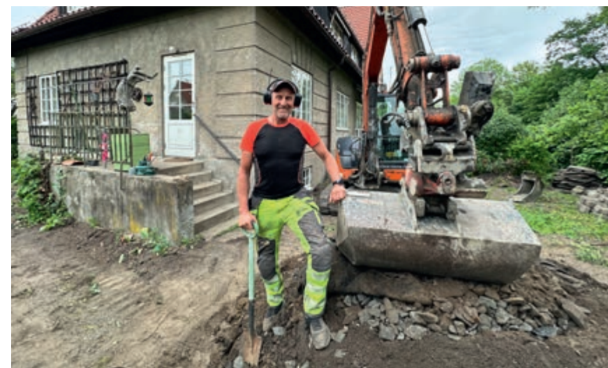
Det er store masser som graves opp ved drenering. Her er Erik Trehjørningen i Graving og Transportservice i aksjon. Foto: Olav Rokseth
